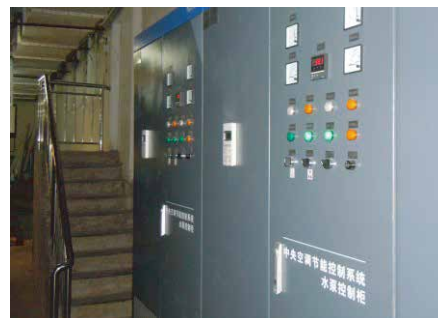
[Hệ thống điều khiển điều hòa không khí lắp đặt trong dự án ESCO]
