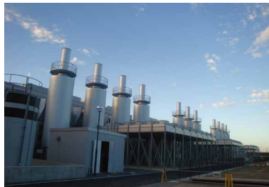
Nhìn toàn cảnh của nhà máy điện Nihon Techno.
