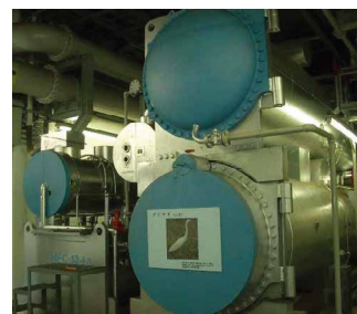
Тепловой насос для утилизации тепла сточных вод
