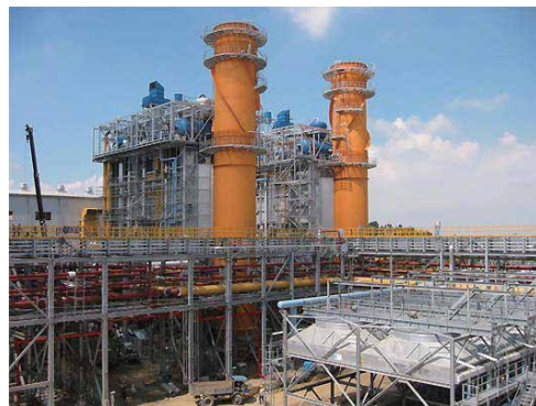
Электростанция в Chang –Bin (Тайвань)
