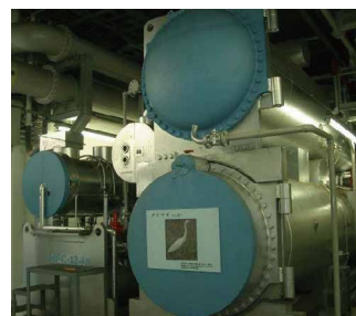
Bomba de calor aproveitando o calor das águas de escoamento
