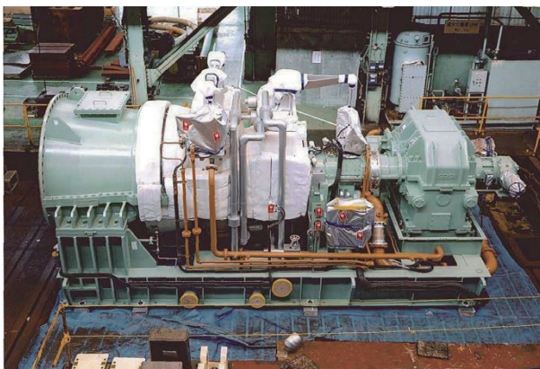
Turbina a vapor para CDQ
