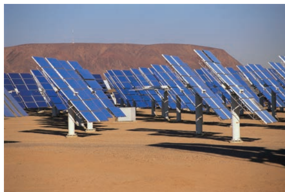
Geração de energia solar fotovoltaica
