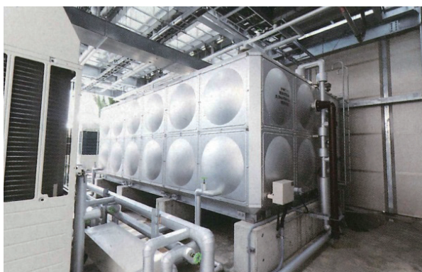
（エコキュート貯湯槽）
