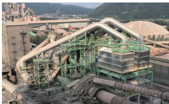
セメント廃熱発電設備 (韓国 Ssangyong Cement)
