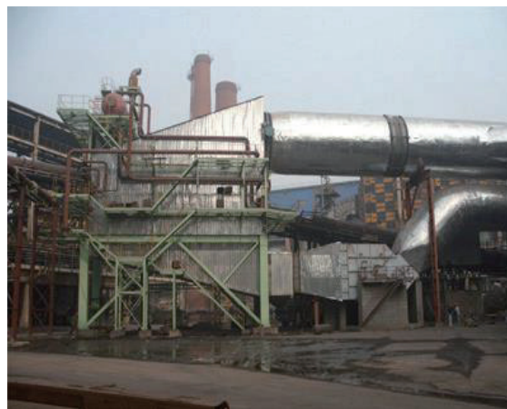
焼結クーラー廃熱発電設備 (中国武漢鋼鉄)
