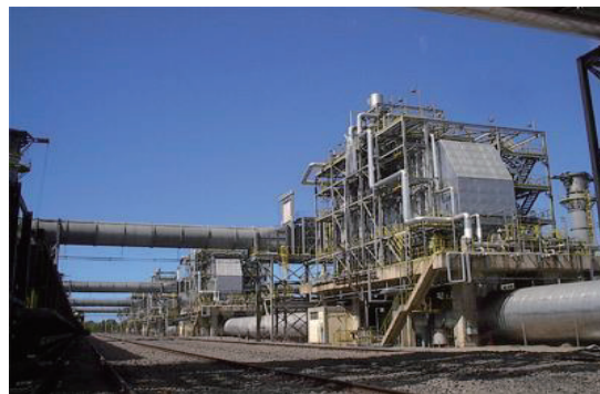
コークス炉廃熱発電設備 (ブラジル ARCELOR-MITTAL-TUBARAO製鉄所)
