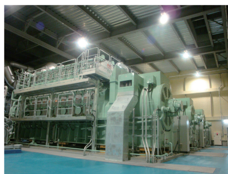
日本テクノ発電機室内
