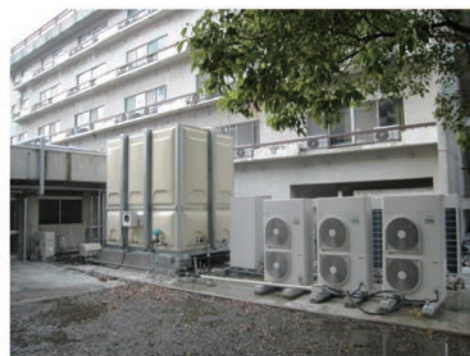
（热泵机组、储水槽）
