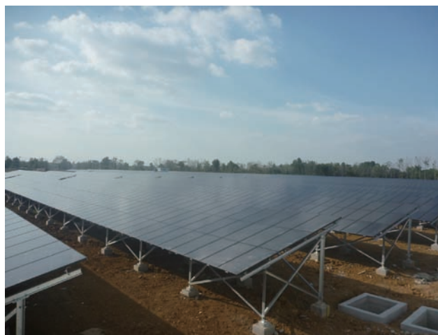
Mega Planta solar de Gunkul Powergen S.A. en Tailandia
